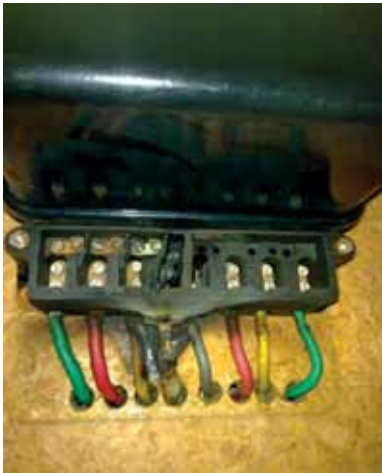
Exemple 1 : au niveau du bornier compteur
